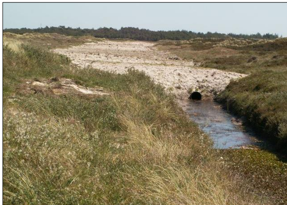
Figur 5. Rørlægning af en del af afløbsgrøften fra Henne Stand er her netop gennemført.
