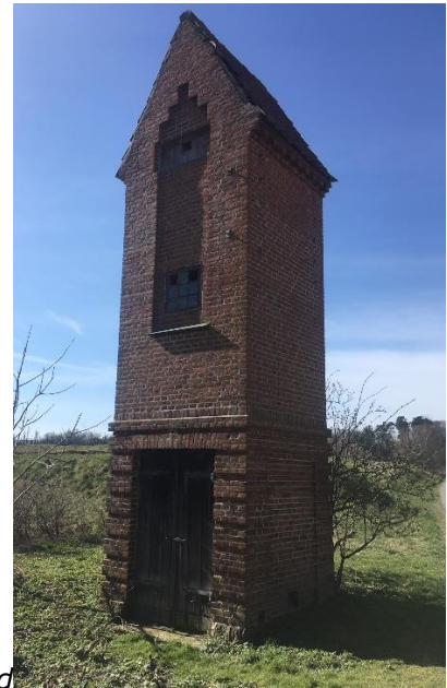
Figur 10. Transformertårnet ved Dronningholm.
