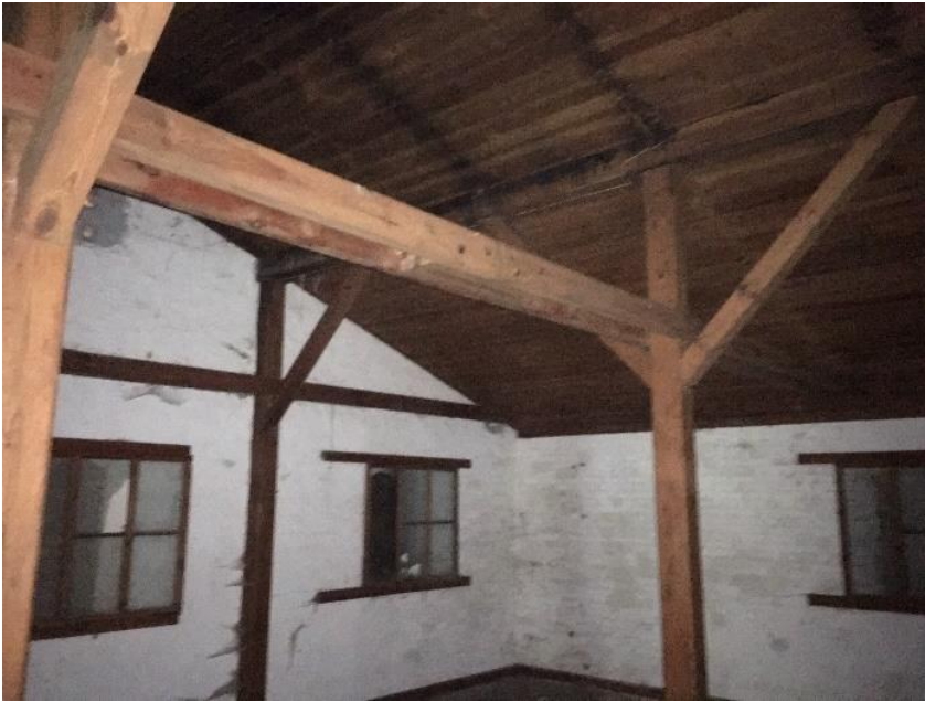
Figur 9. Krudtmagasinet har tykke mure og bræddeloft, så en eksplosion ville forplante sig opad.
